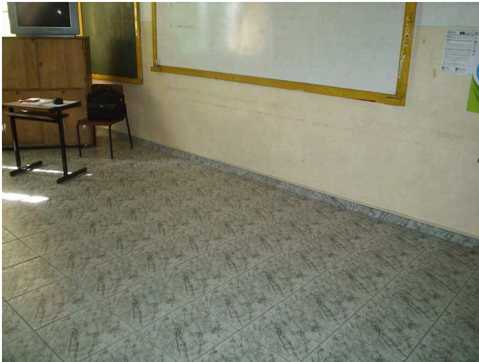
Figura 6. Piso cerâmico: prejudica a qualidade acústica da sala de aula. (Fonte: O autor)
