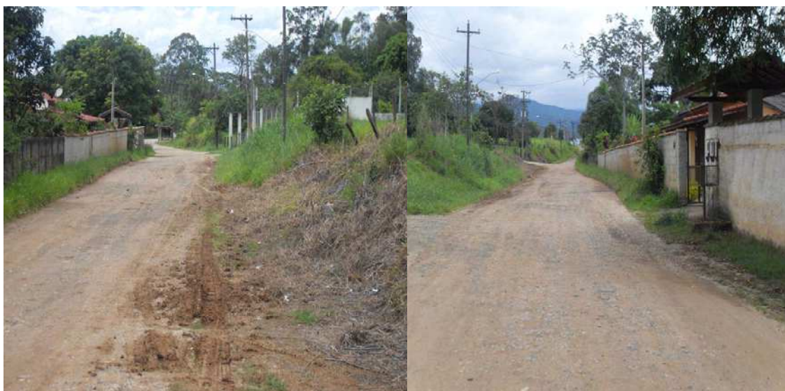
FIGURAS 10B e 10C: Foto in loco do setor Cruz Grande, indicando ausência de cobertura asfáltica. Zona rural de Pindamonhangaba-SP.
