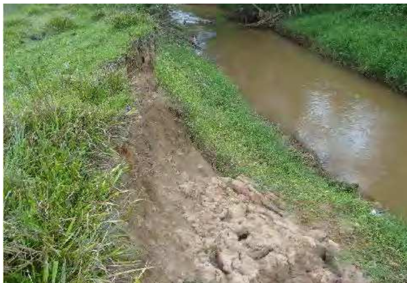
Figura 36: Assoreamento das margens.
