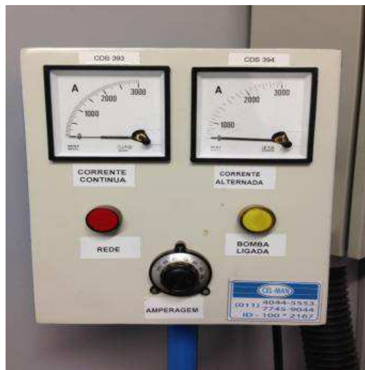
Figura 24 – Painel de comando elétrico
