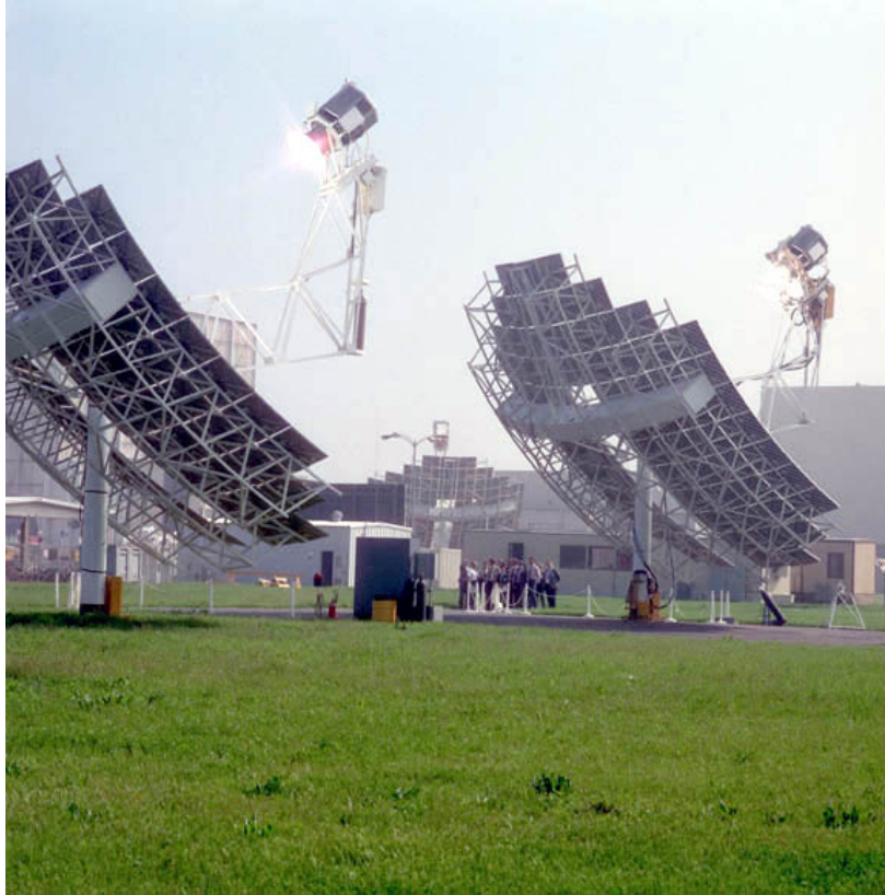
Fig. 9 – Conjuntos motogeradores e concentradores parabólicos Califórnia Edison, EUA (SANDIA, 2006)
