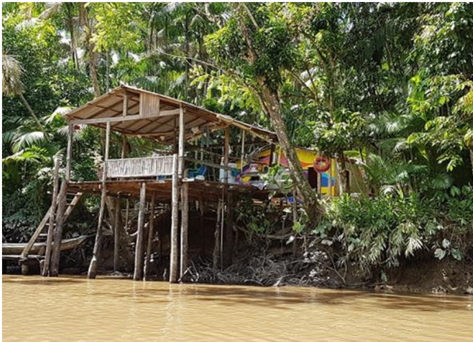
Figura 5 - Fotografia de Assentamento ribeirinho na Ilha do Combu - Encostas com processos de erosão.
