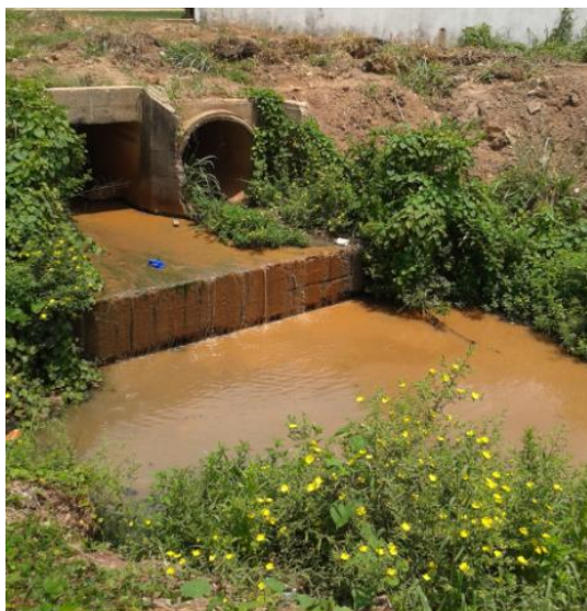
IMAGEM 1- Galeria: SAÍDA DE ÁGUA . Av.Rotary Clube
