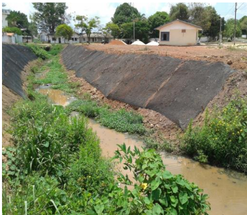
IMAGEM 2, 3 e 4 – corredor de água com tela para evitar erosão
