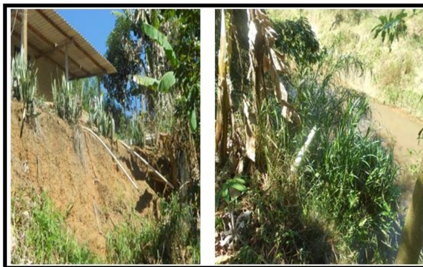
Figura 11: Lançamento de esgoto às margens do Rio Una
