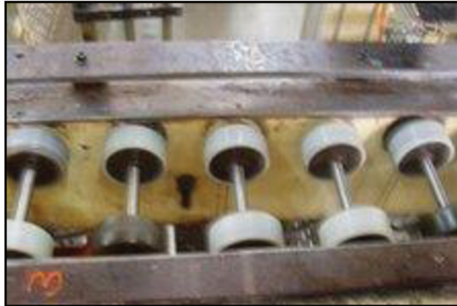
Figura 7 - Inexistência de réguas guia de nylon no transportador
