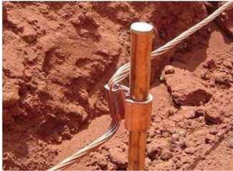
Figura 27: Haste de aterramento
