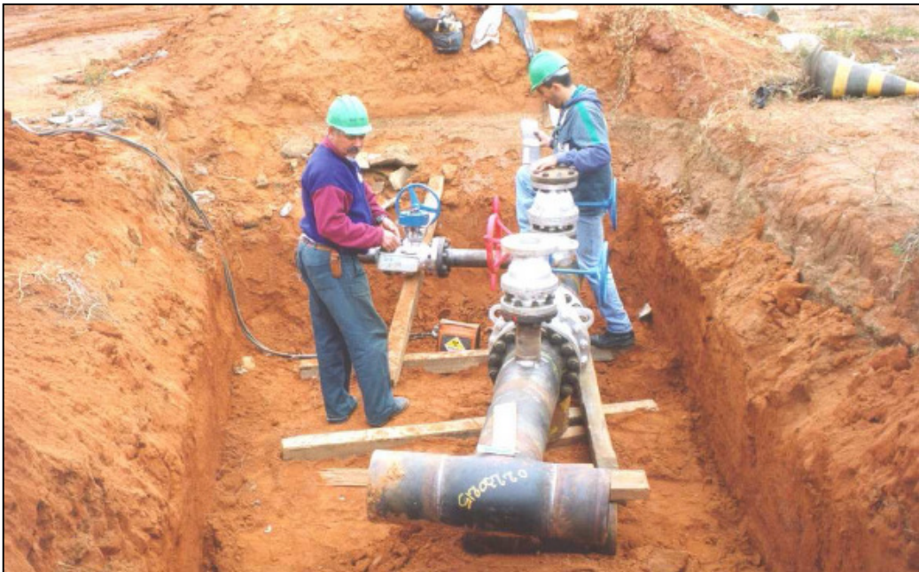
Figura 8 Exemplo de instalação aberta
