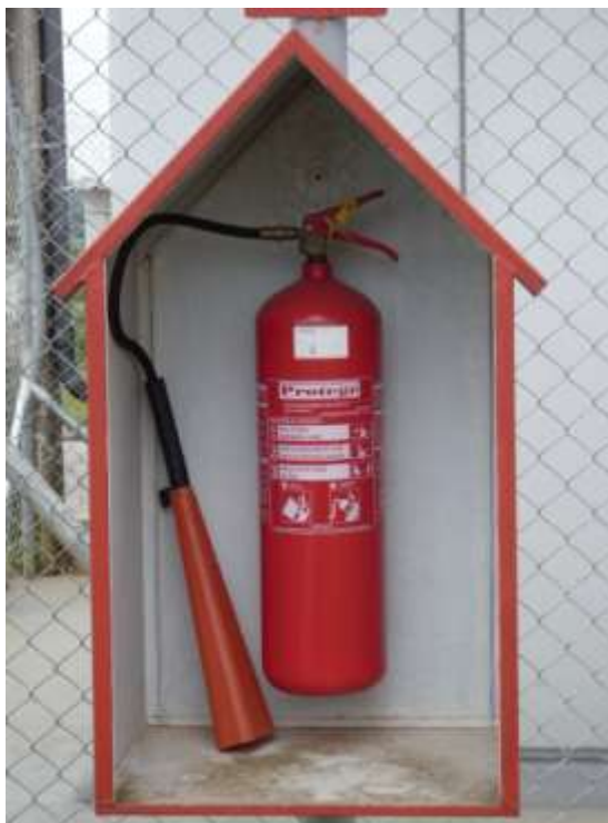
Figura 19 Extintor próximo a cabine primária Fonte: A autora, 2009.
