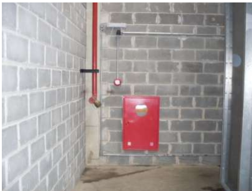
Figura 15 Conjunto do hidrante, sirene e acionador manual Fonte: A autora, 2009.
