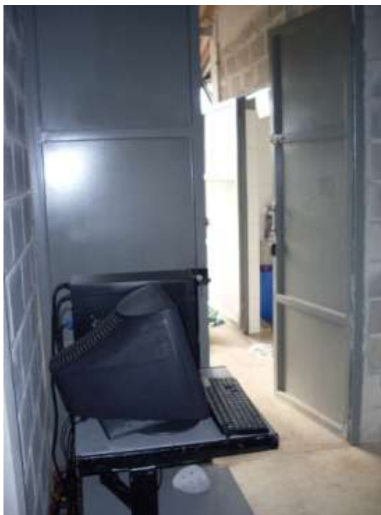
Figura 17 Ausência de sinalização de saída de emergência e obstrução Fonte: A autora, 2009.
