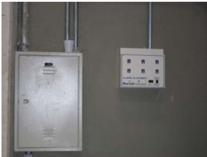
Figura 13 Central de alarme Fonte: A autora, 2009.
