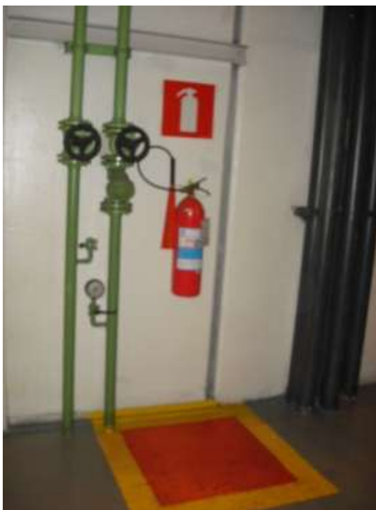
Figura 20 Modelo de sinalização de piso e pictograma de extintor Fonte: Yuri Vieira, 2009.
