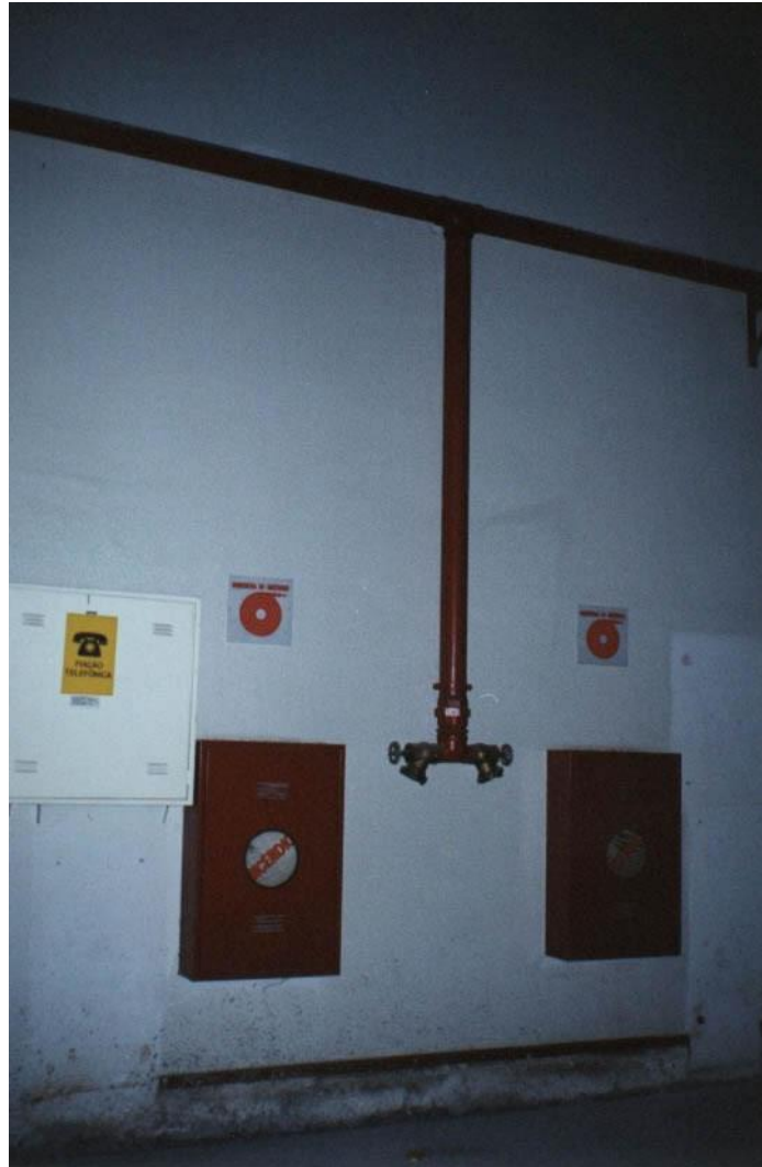
Figura 15 Rede hidráulica com hidrantes e mangueiras
