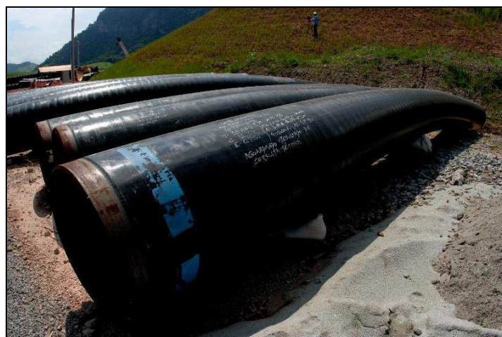
Figura 39. Tubos curvados (PETROBRAS, 2017).
