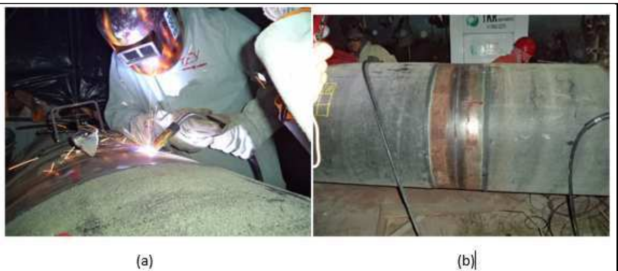
Figura 46. (a) Soldador executando a soldagem de dois tubos. (b) Soldagem de dois tubos concluída (PETROBRAS, 2017).
