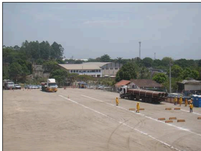
Figura 25. Profissionais trabalhando na preparação de um canteiro para armazenagem de tubos (PETROBRAS, 2014).
