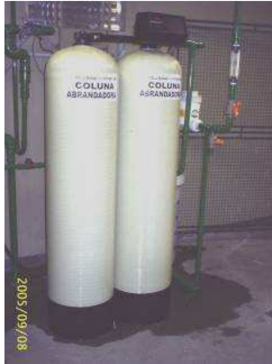
Figura 8 – Foto de duas colunas com resinas iônicas que promovem o abrandamento da água bruta (STELLA RESINAS, 2010)
