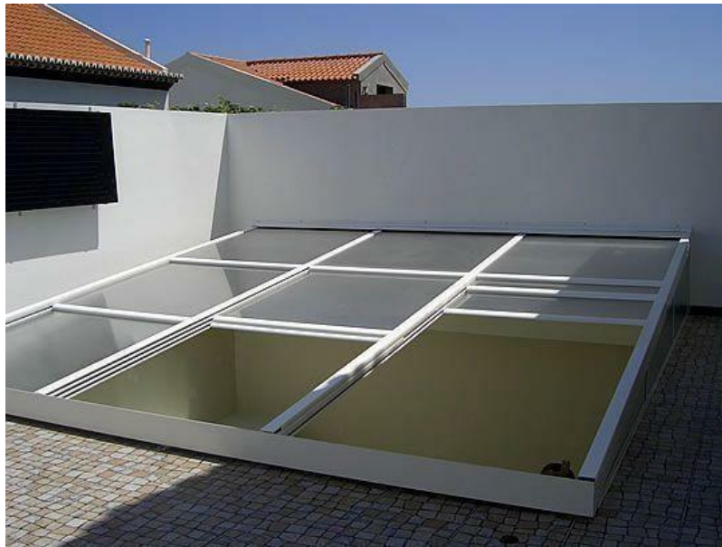
Figura 36: Abertura zenital com fechamento retrátil.
