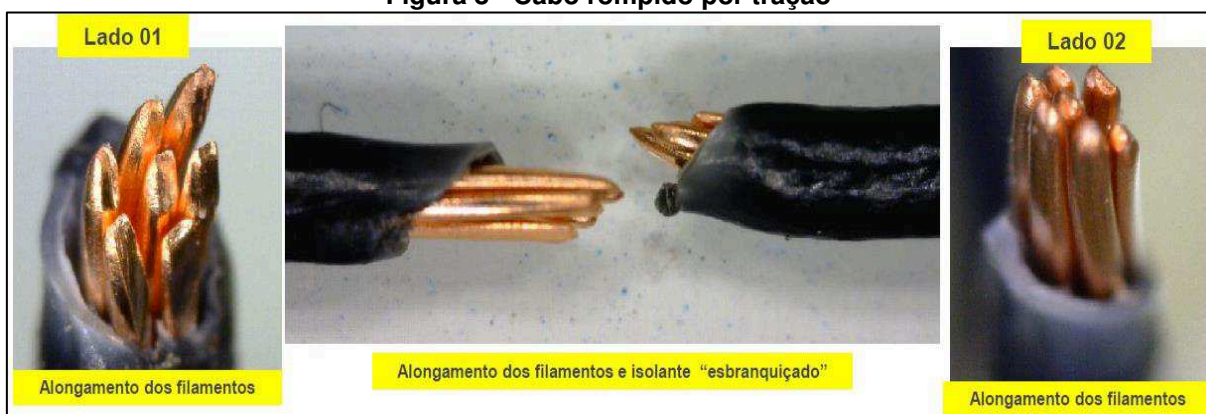
Figura 8 - Cabo rompido por tração
