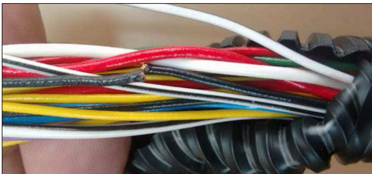
Figura 3 - Cabo rompido isoladamente
