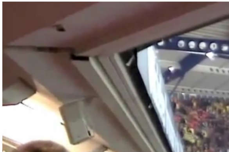
FIGURA 1: DESLOCAMENTOS EXCESSIVOS NO ESTÁDIO FRANKENSTADIUM
