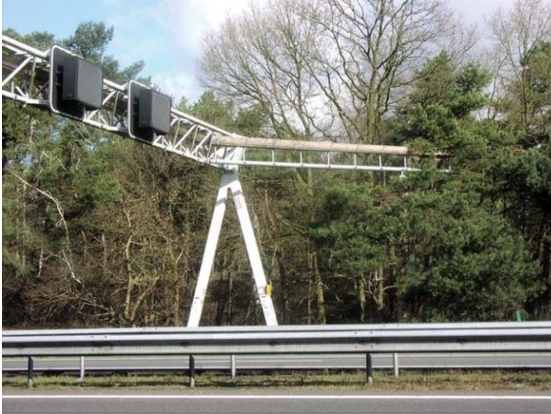
Figura 16: Exemplo de passagem instalada na sinalização em uma rodovia.
