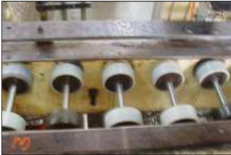
Figura 7 - Inexistência de réguas guias de nylon no transportador
