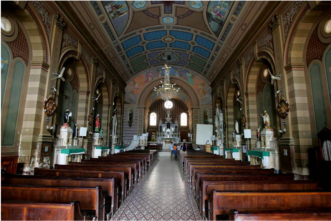
Figura 20 - Interior da Igreja Matriz anos antes de sua queda. Pela imagem podemos notar que o local já precisava de reparos na pintura interna.
