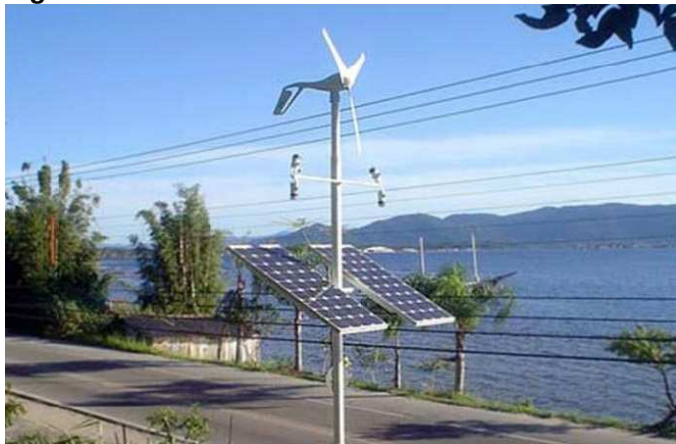
Figura 7a: Sistema Híbrido Eólico-Fotovoltaico
