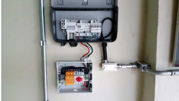
Figura 43a: Conexão da Stringbox ao Inversor
