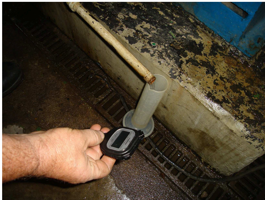
Figura 20: Medição de vazamento proveniente da gaxeta (Sabesp, 2008)
