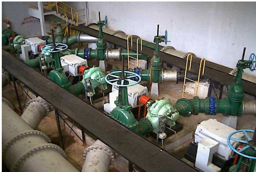
Figura 1: Componentes da estação: bombas, motores, válvulas e tubulações (Sabesp, 2008)
