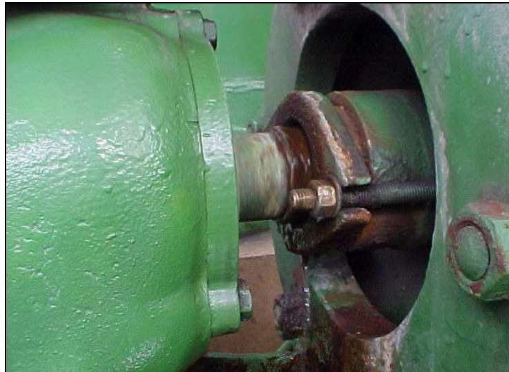
Figura 8: Vista do sistema de engaxetamento e preme-gaxeta (SABESP, 2008)
