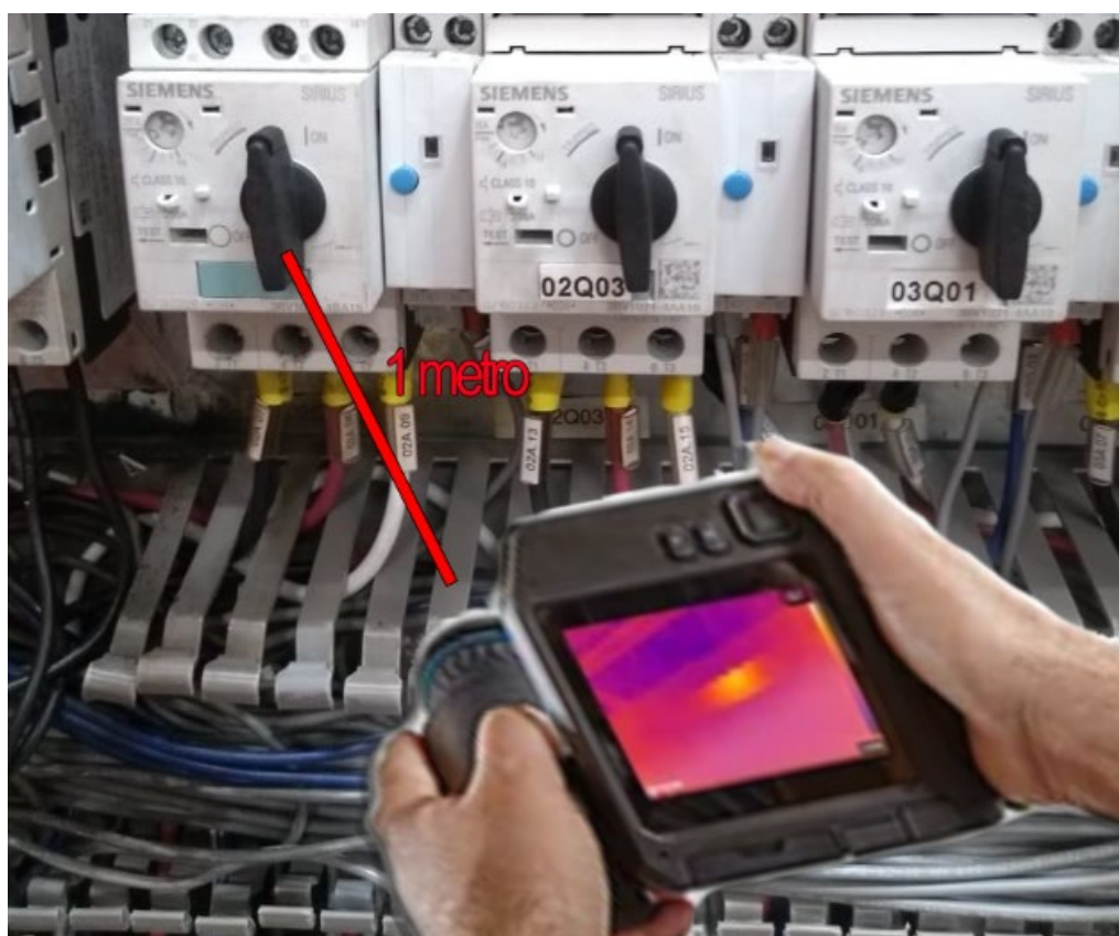
Figura 15 - Inspeção termográfica Disjuntor 02Q03.
