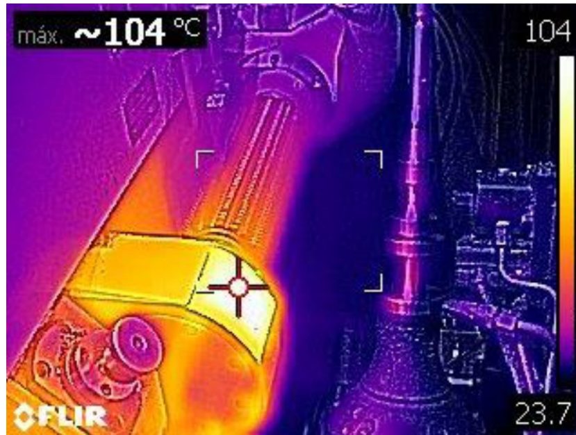
Figura 17 - Termografia Rolamentos eixo Gleason 0660000429.
