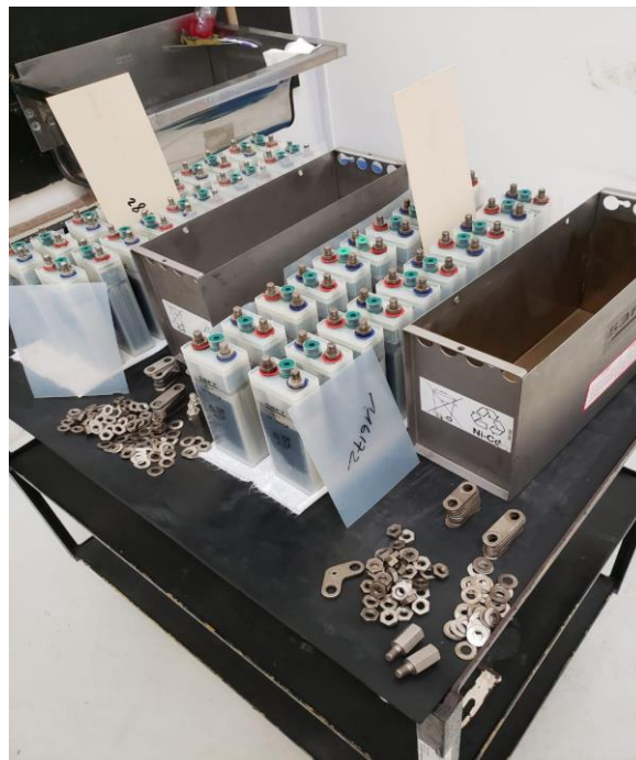
Fig.8 – Verificação geral na bateria PN 1606-1
