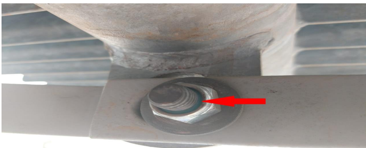
Reator instalado na subestação Taubaté pertencente a área da Copel Geração e Transmissão. Fonte: Próprio autor.
