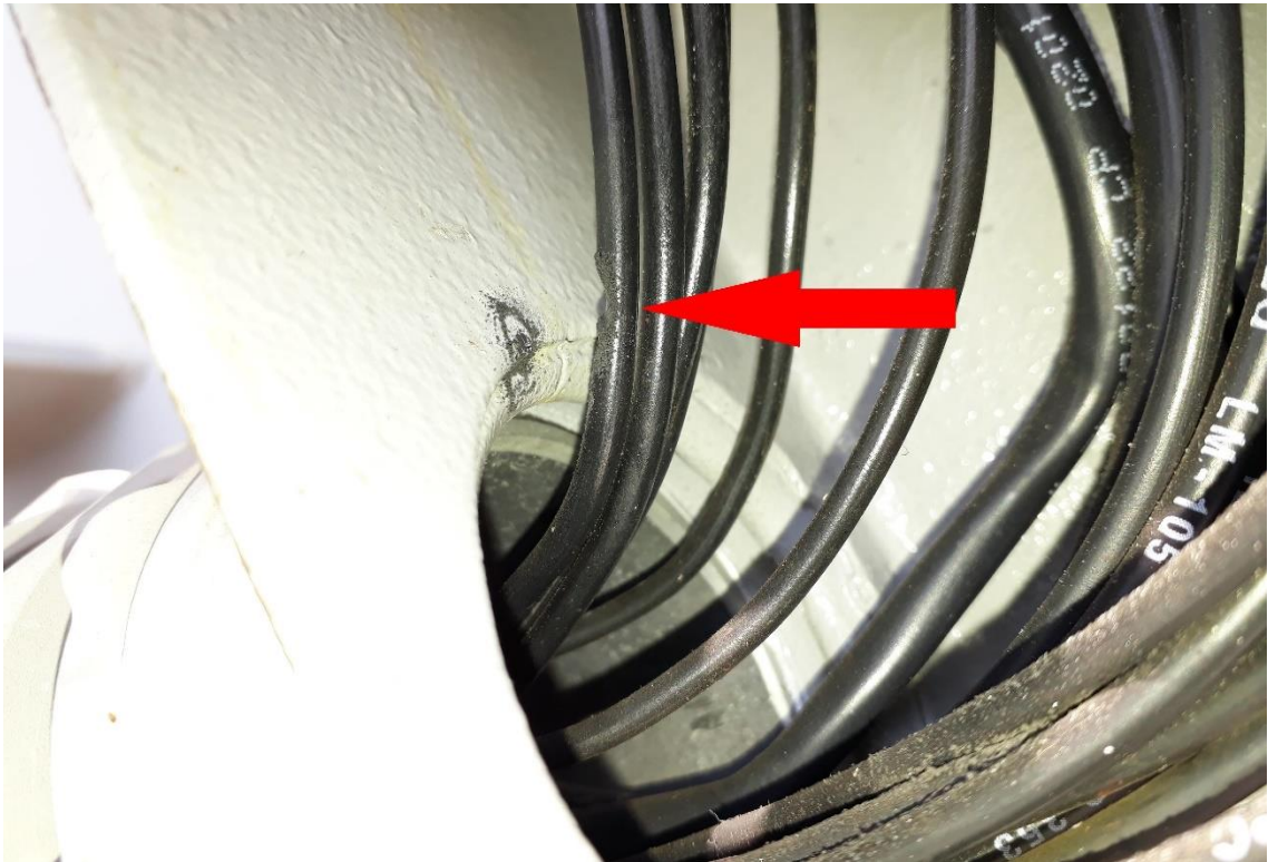
Reator instalado na subestação Taubaté pertencente a área da Copel Geração e Transmissão. Fonte: Próprio autor.
