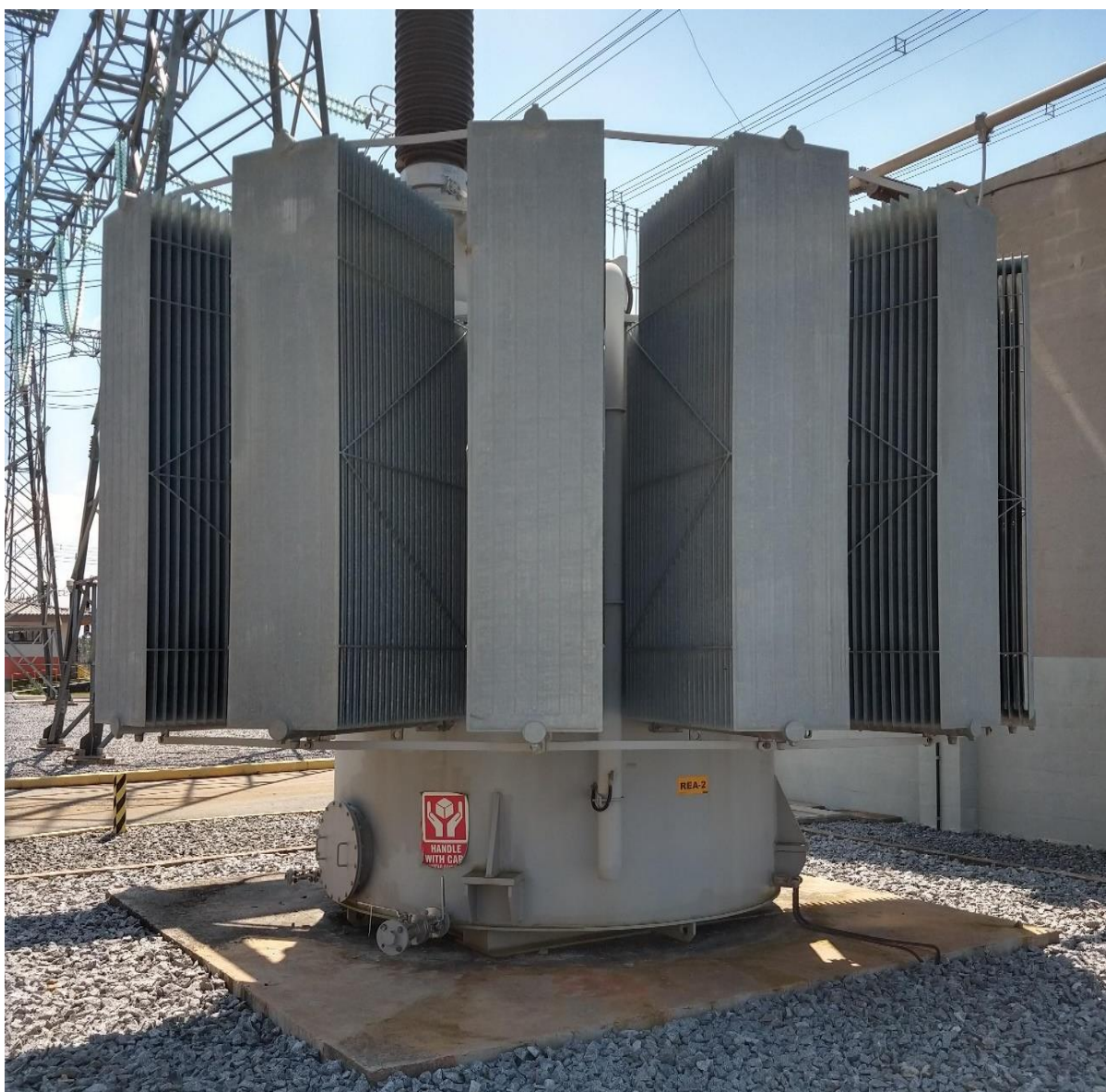
Reator instalado na subestação Taubaté pertencente a área da Copel Geração e Transmissão. Fonte: Próprio autor.
