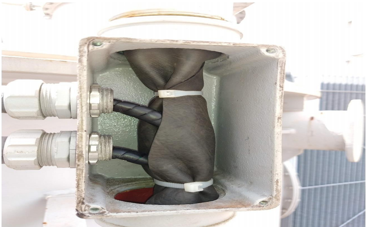
Reator instalado na subestação Taubaté pertencente a área da Copel Geração e Transmissão. Fonte: Próprio autor.
