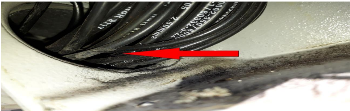
Reator instalado na subestação Taubaté pertencente a área da Copel Geração e Transmissão. Fonte: Próprio autor.
