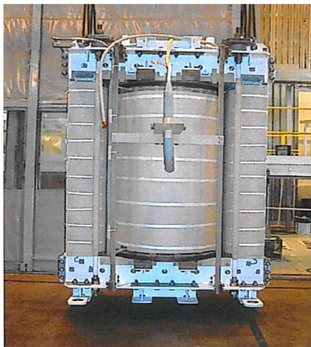
Figura 20: Núcleo e conector da bucha de alta tensão
