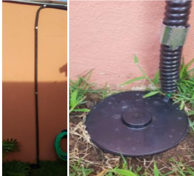
Figura 30: Aterramento do sistema de geração de energia solar fotovoltaica
