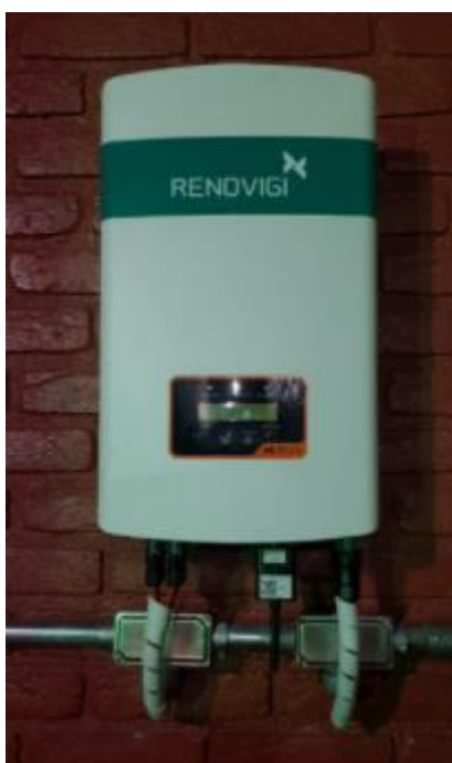
Figura 27: Inversor central instalado na residência
