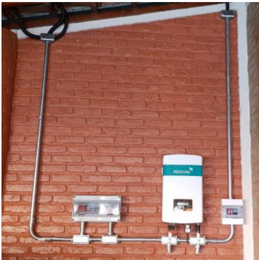
Figura 28: Dispositivos de proteção CC e CA interligados ao inversor central
