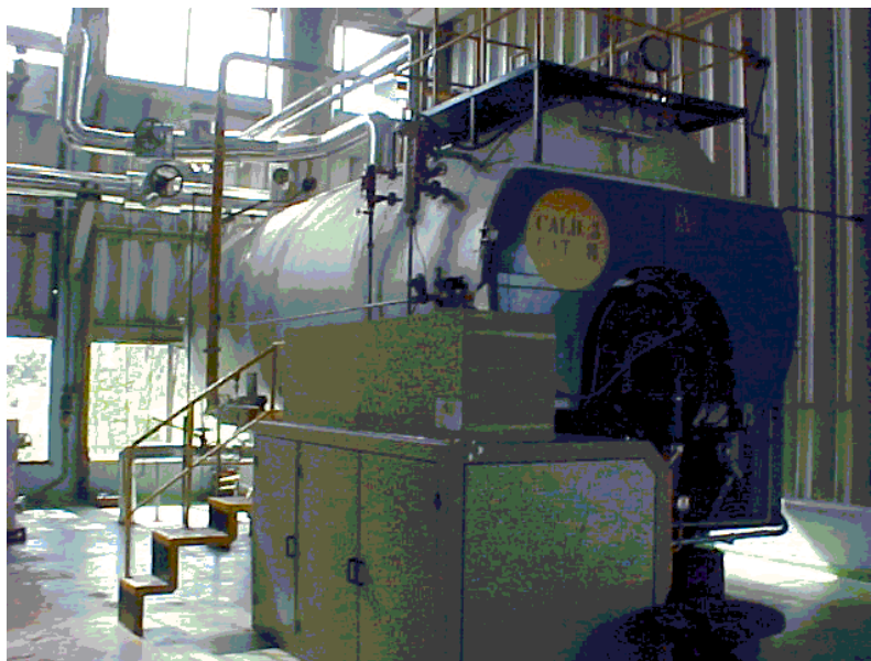
Figura 7 – Caldeira fogo-tubular a gás natural.
