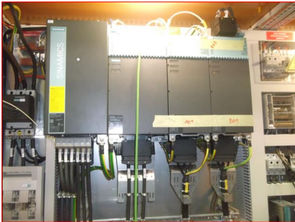
Figura 36 - PLC Siemens Fonte: Autor
