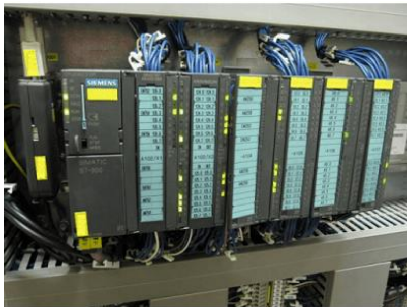
Figura 1 - PLC Siemens Fonte: Autor
