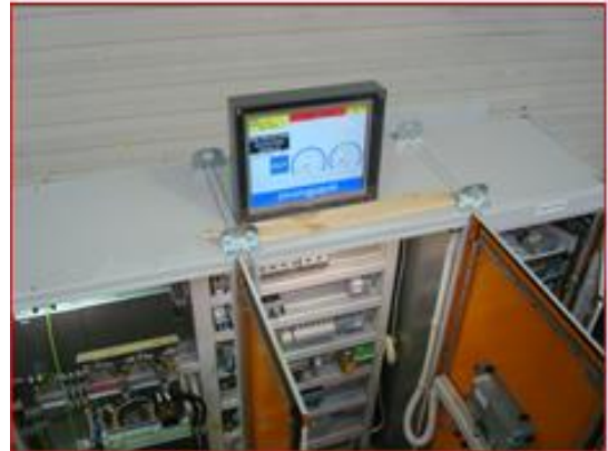
Figura 9 - Painel elétrico e monitor
