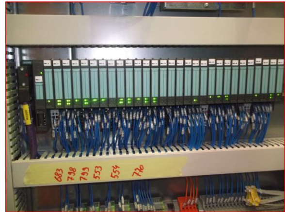
Figura 37 - I/O PLC Siemens Fonte: Autor
