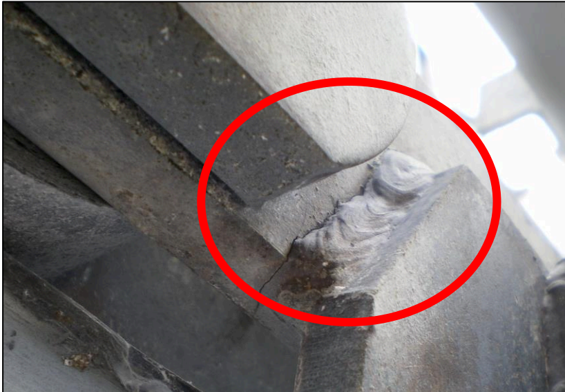
Figura 21 - Corrente com trinca na região da solda
