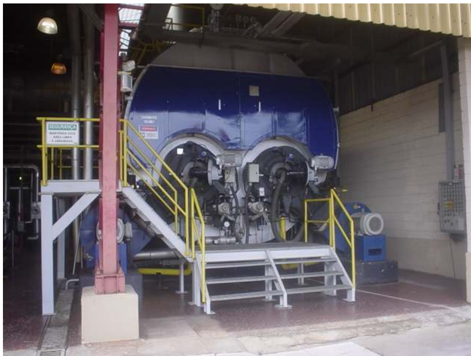
Figura 10 – Foto da Caldeira para Geração de Vapor movida à Gás Natural
