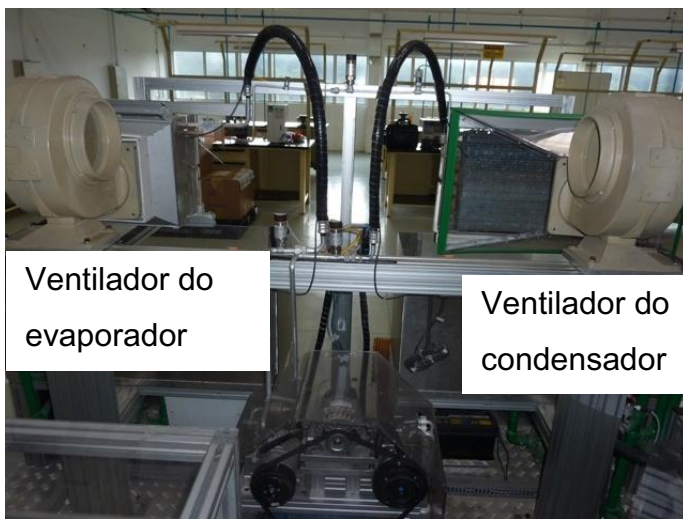
Figura 20 - Ventiladores marca Asten, acoplados aos trocadores de calor, evaporador e condensador
