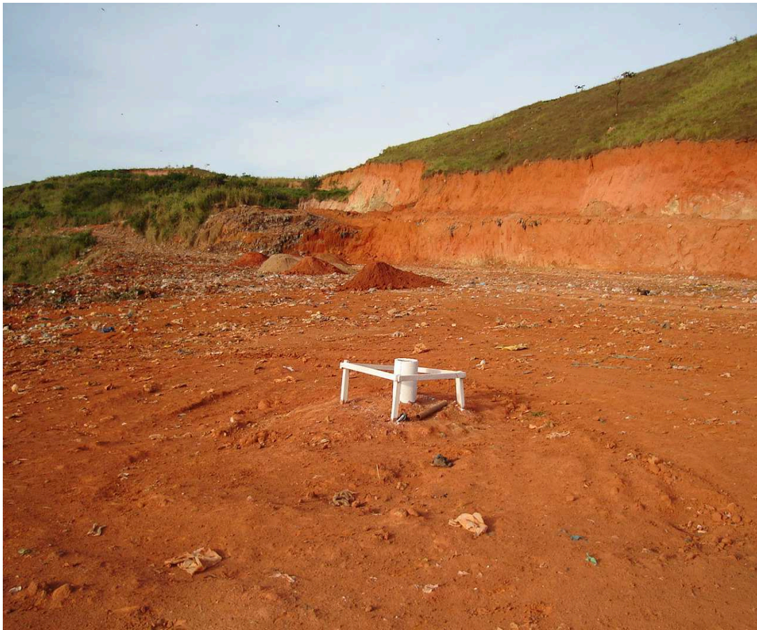
Figura 19. Dreno de gases
