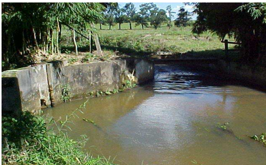
Figura 10. Entrada d'água bacia, canal de derivação, divisor de água a jusante do Reservatório da Maristela. Coordenadas UTM 0437222 e 7463648.
