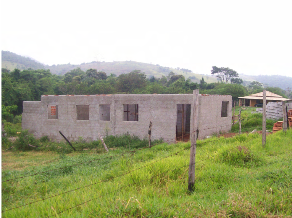
Figura 4. Foto de uma construção em andamento situada dentro dos limites de APP (margem do ribeirão Itaim) no Bairro do Cataguá.
